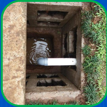
2,3K Sumur Resapan
